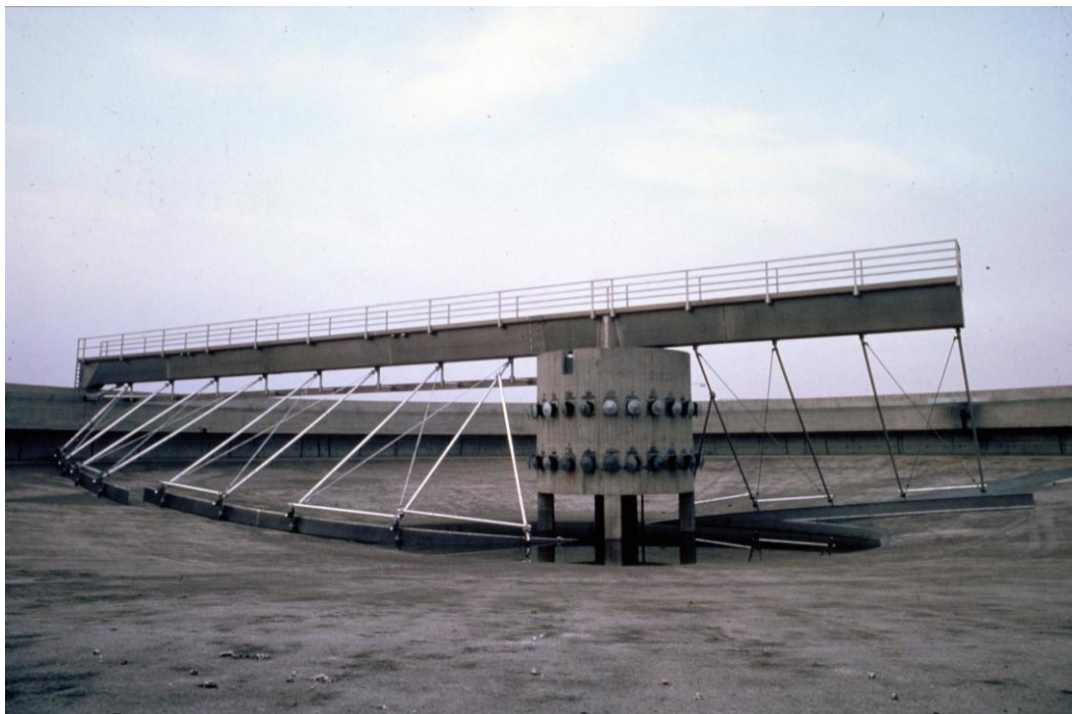
Figura 0-7.1: il carroporte rotante dell'impianto di depurazione Po-Sangone a Torino
